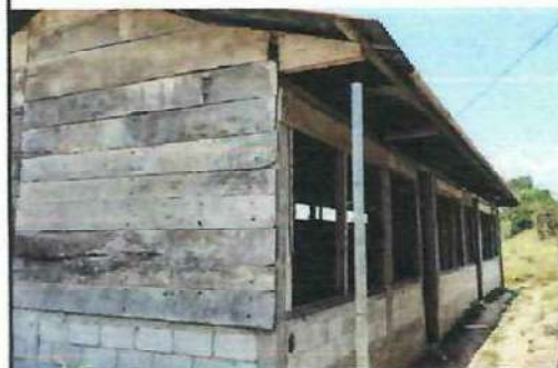
FOTO 4: VENTANAS SIN NINGUN TIPO DE SEGURIDAD
