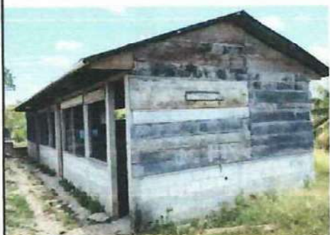
FOTO 1: SE SOLICITA EL MANTENIMIENTO DE ESTAS AULAS QUE SE ENCUENTRAN EN ABANDONO
