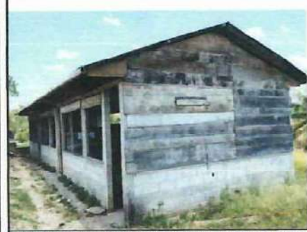
FOTO 5: ESCUELA NO TIENE NINGUNA PUERTA Y ESTA DESPROTEGIDA
